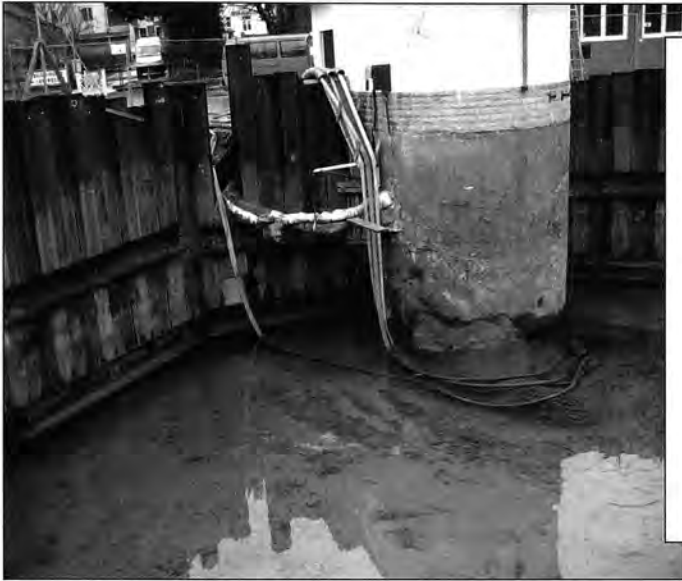
Grundwasserandrang in der Baugrube
