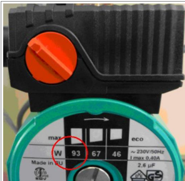
Abb. 1: An der abgebildeten Heizungsumwälzpumpe können drei Leistungsstufen eingestellt werden (roter Schalter). Eingestellt ist dabei die Stufe 3, bei der die Leistungsaufnahme laut Typenschild 93 Watt (W) beträgt. Zum Vergleich: ein modernes Notebook benötigt im normalen Betrieb zwischen 15-35 Watt.
